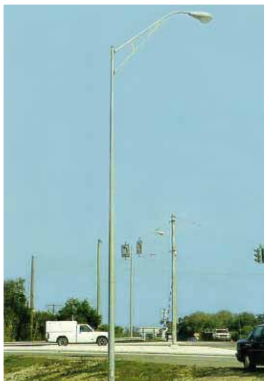
Postes de alumbrado galvanizado
